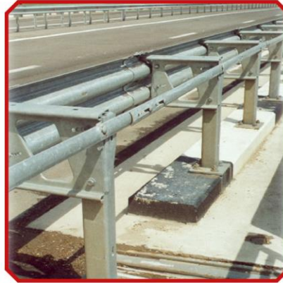
Крепление барьерного ограждения
